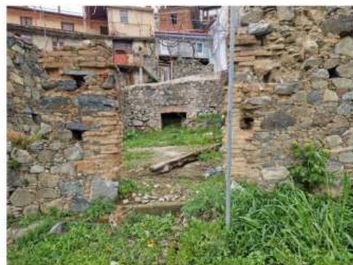
Κατάρρευση ή απουσία ανοιγόμενων στοιχείων
